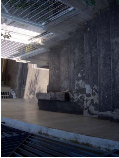
24. 一般の通常利用が多い階段。蹴上げ、踏み面が一定しないので危険。助成金等で改善の可能性がある。
