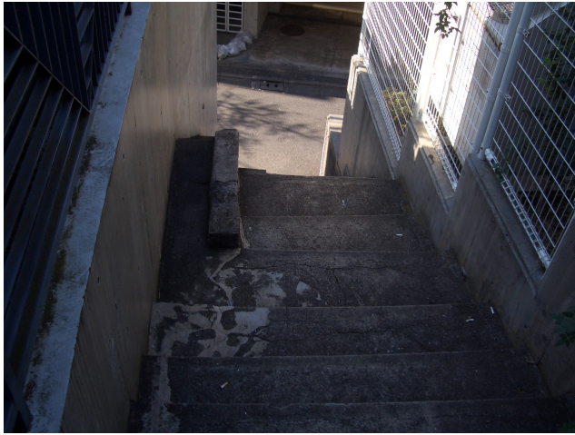
43 一般の通常利用が多い階段。蹴上げ、踏み面が一定しないので危険。助成金等で改善の可能性がある。
