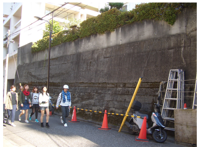
18 擁壁ブロックの上にコンクリートブロック、その上にコンクリート塀の3仕様。倒壊も予想される。
