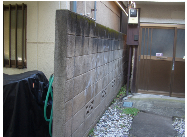
20 コンクリートブロック7段、私有地だろうが倒壊の恐れはある。
