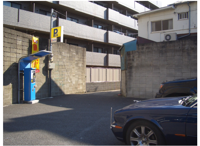
26 周囲、コンクリートブロック塀。16段、3.2mもあり極めて危険。
