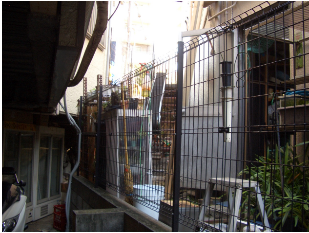
31 写真10を下から見る。個人のものだが、普段も使用は困難、避難時は期待できない。
