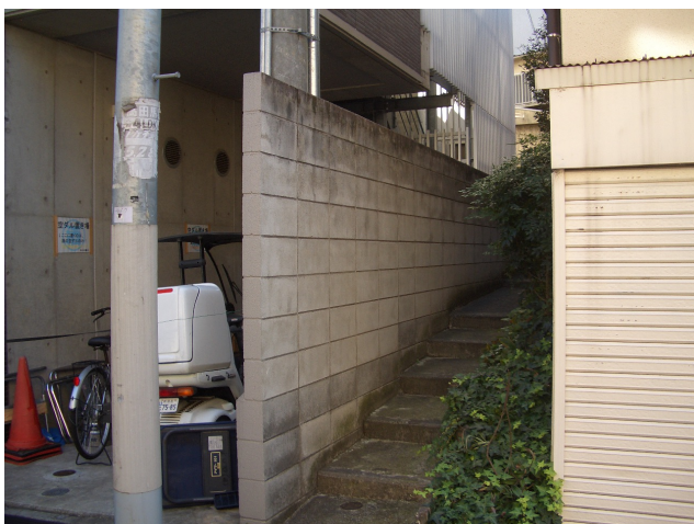
29 コンクリートブロック11段、高さ2.2Mは危険。
