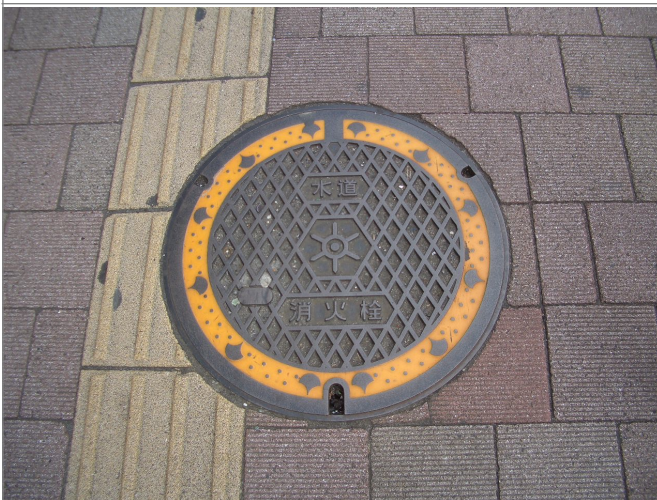
59 消火栓マンホール
