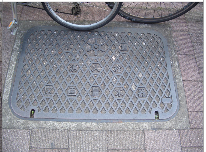
60 消火栓マンホール
