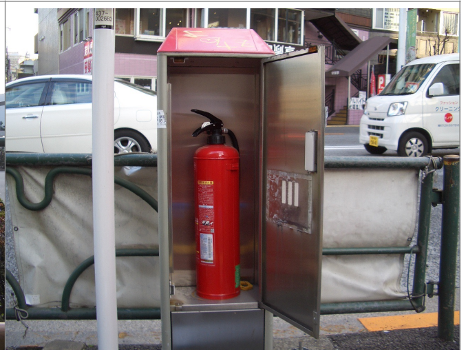
56 消火器3型17台、 路上設置のほか壁掛け型8台
