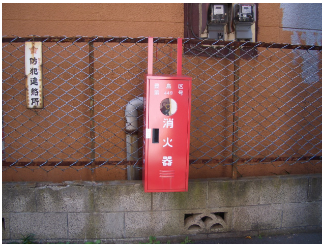
15 所々に消火器設置。共同利用の助け合いの意識をさりげなく芽生えさせている。
