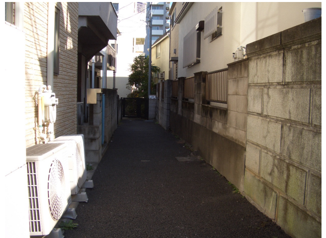
28 路地 大谷石積み。倒壊の危険性はある。
