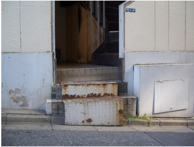
13 建物の避難階段から道路に下りてくる。段差が突然に異なるので危険。
