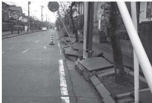
浦安地区：液状化に電柱が大きく傾き道路も大きく沈下
